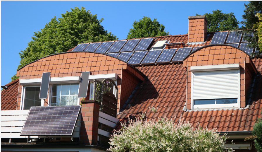
Abb. 3: Drei verschiedene dezentrale, photovoltaische Energieerzeugungsanlagen [3]. Sie werden auch Solargeneratoren genannt, denn in ihren Halbleitern (Silizium) wird elektrische Energie generiert durch Sonnenlicht. Ihre Leistungen: Dach: 2 kW, Balkon: 2x0,012 kW, Geländer: 0,265 kW.
